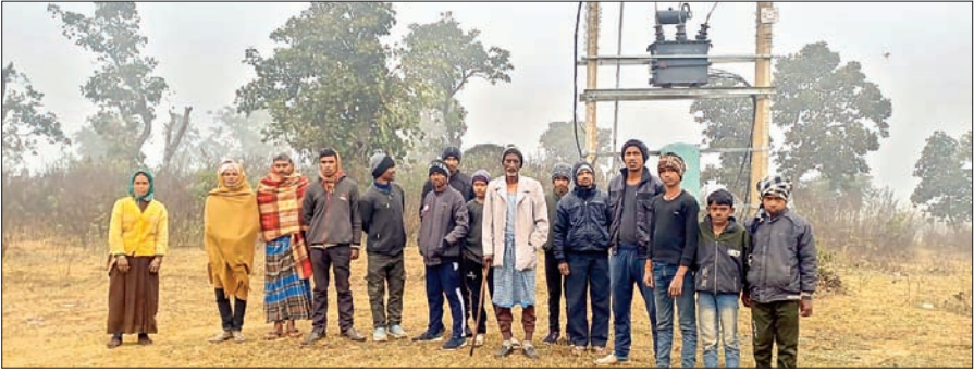
बरवाडीह के अहीरपुरा गांव में प्रजापति टोला में ट्रांसफॉर्मर लगने के बाद खुशी मनाते ग्रामीण।
